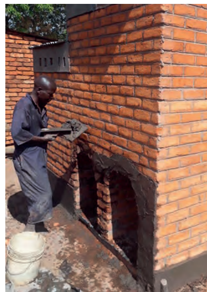
Die ersten Trockentrenntoiletten sind kurz vor der Fertigstellung. Zu sehen sind die beiden Kammern für flüssige und feste Bestandteile.
