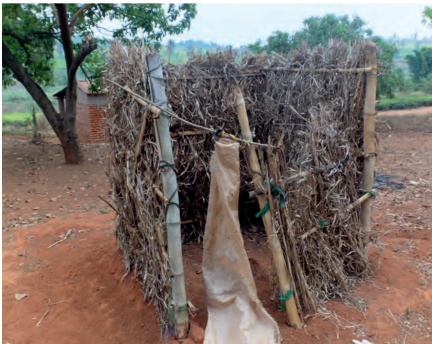
Die alten Latrinen sind nicht überdacht und nur mit einem einfachen Sichtschutz versehen.
